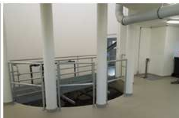
foto: COV technologické zařízení
