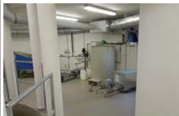
foto: COV technologické zařízení
